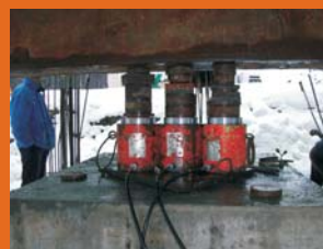
Piloți "in situ". Injecțare piloți. Test încercare statică. Pasaj Ștefănești - Centură București
